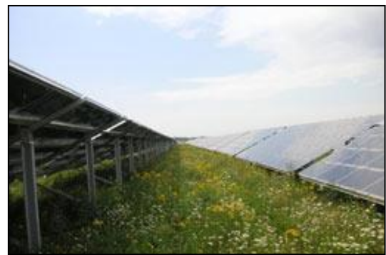
Abb. 12: Beispiel „Aufgeständertes Modulfeld“
