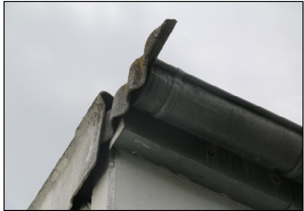
Abb. 14: Dachaußenhaut mit Spalte bzw. Nische
