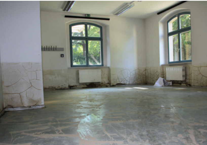
Durchfeuchtete und verschmutzte Außenwände nach Überflutung
