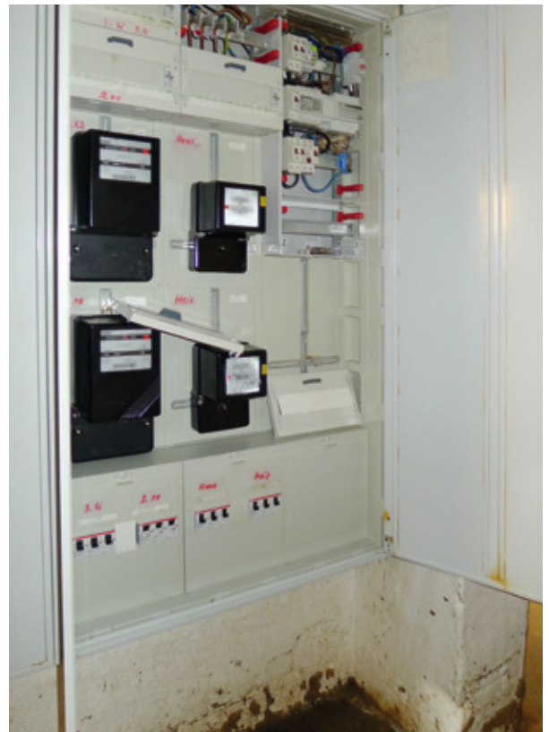
Überfluteter Sicherungsasten in einer Erdgeschosswohnung
