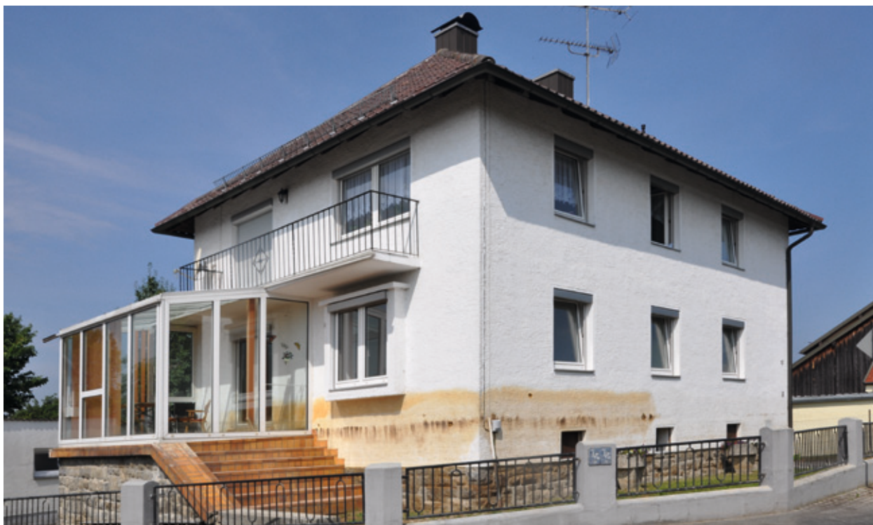
Mit Heizöl belastetes Wärmedämm-Verbundsystem eines Wohnhauses
