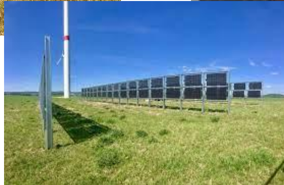
Vertikale Freiflächenanlage PV
