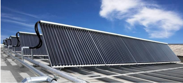
Vakuum Röhrenkollektorfeld Quelle: Ritter Solar XL
